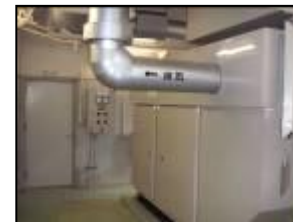
非常用発電機
