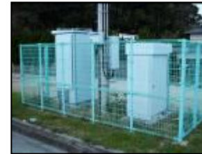
マンホールポンプ用 制御盤・非常用発電機
