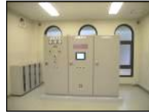
ポンプ制御盤
