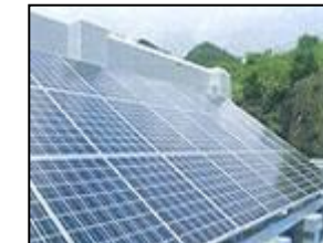
太陽光等自然エネ ルギー利用システム
